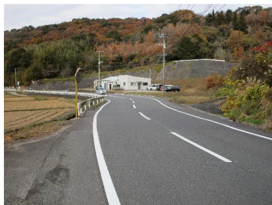
ソーラー発電所入口付近～牛旁の白線
